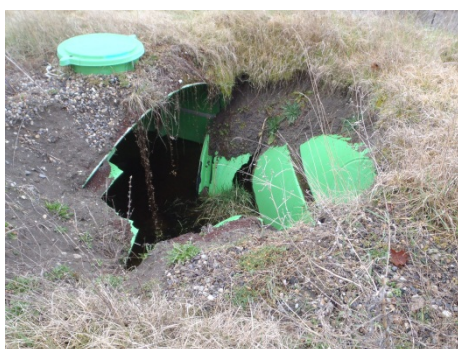
Effondrement d'une des deux fosse toutes eau (STEP)
