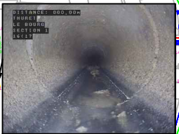
Dégradation de surface
